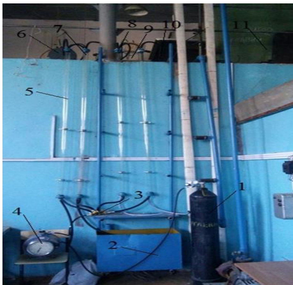
Рисунок 2 - Экспериментальная абсорбционная установка для обогащения биогаза проточной воды
